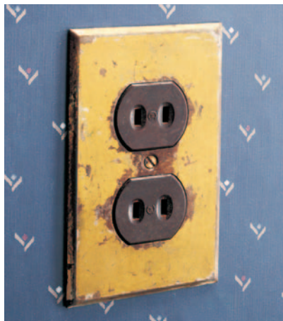
Los tomacorrientes no polarizados tienen aberturas del mismo tamaño. Los enchufes modernos pueden no caber, pero nunca altere las patas del enchufe polarizado para conectarlo en uno no polarizado.
