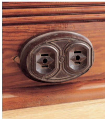
Los tomacorrientes de montura superficial fueron populares entre los años 40 y 50. Los cables corrían detrás de la montura hueca de piso. Estos tomacorrientes son por lo general no polarizados.
